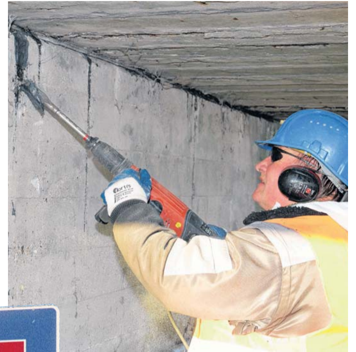
Unterhalb der Straße kam gleich mal der Presslufthammer zum Einsatz, den Auftrag zum Abreißen hat eine Firma aus Rostock bekommen.
